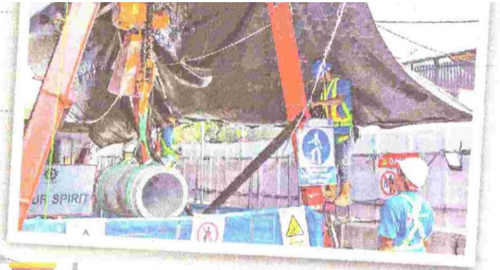
KONSTRUKSI JARINGAN — Lokasi pengerjaan konstruksi jaringan pipa air limbah Jakarta Sewerage Development Project (JSDP) zone 1 di kawasan Pluit, Jakarta Utara, Selasa (12/12/2023) kemarin. Tampak beberapa pekerja masih melakukan pengerjaan proyek tersebut.
