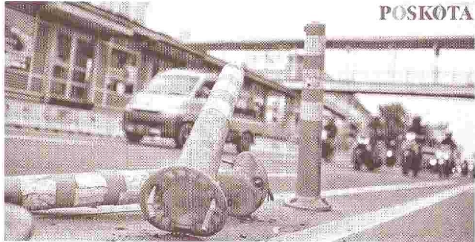
Stick cone yang rusak di beberapa ruas jalan.
